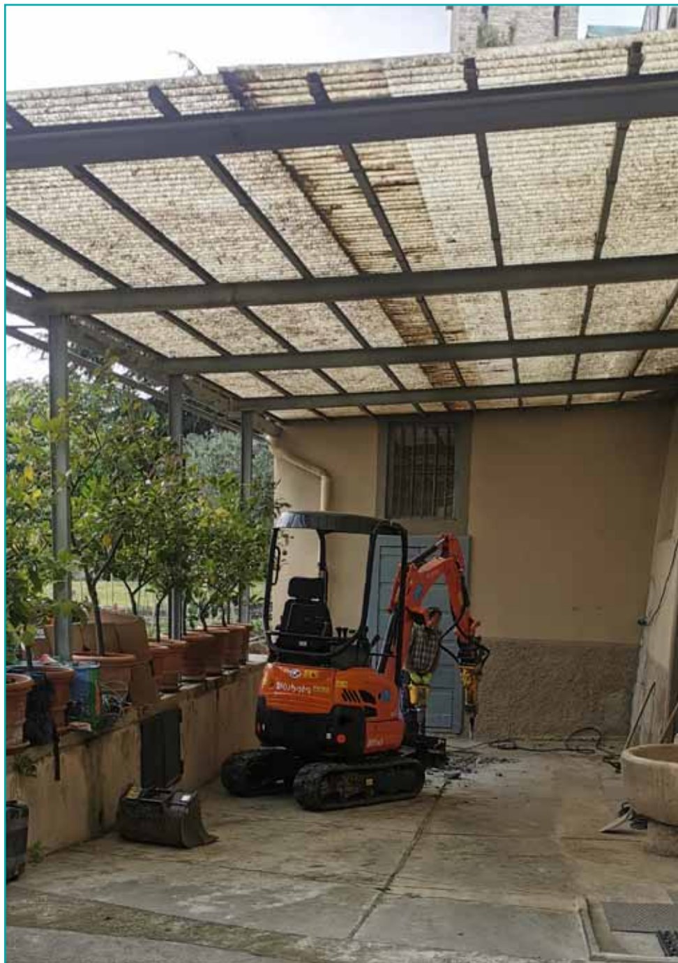
Scivolo e vecchia tettoia con le onduline in plastica e le copertine ammalorate.
